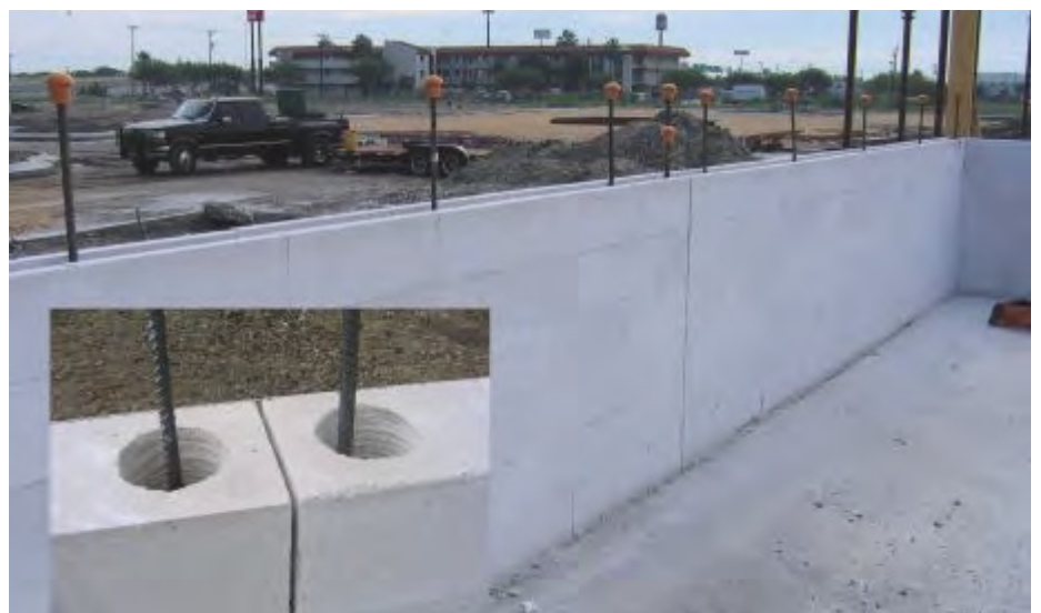
Fig. 17: Junta de control en muro.
