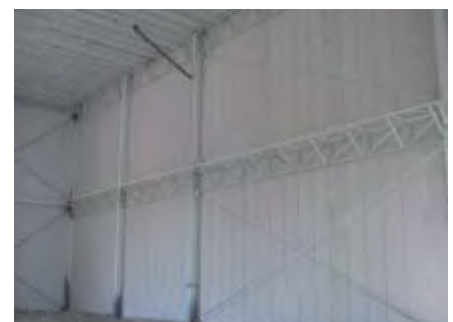
Fig. 22: Vista interior de panel en arreglo vertical.
